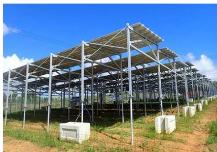
名護市天仁屋 ソーラーシェアリング (20基)
